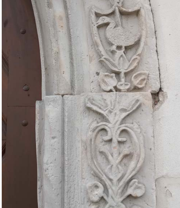
Deformacje gotyckiego portalu kolegiaty pod wezwaniem św. Marcina z Tours w Opatowie sugerujące ich powstanie w wyniku trzęsienia ziemi | fot. Krzysztof Gaidzik
